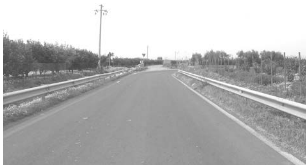
Figura 23 – Tronco stradale sulla S.P. 77 (distanza ridotta).
